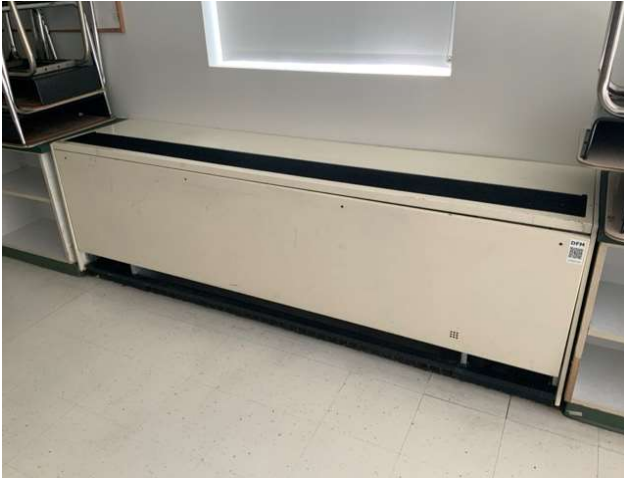
19 - FAN COIL UNIT
